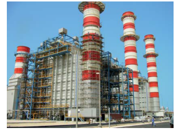
Turbina gazowa Siemens SGT5-4000 w Katarze
