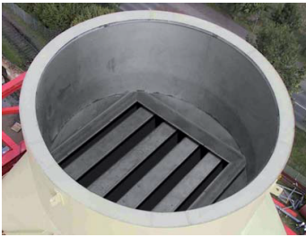
Komin spalinowy w tłumikami
