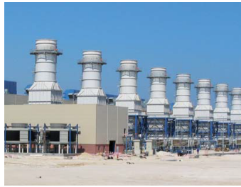
Turbina gazowa Siemens V 94.2 na Środkowym Wschodzie
